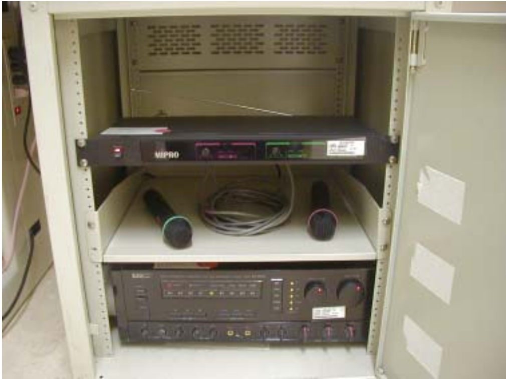
圖 3-18 音響櫃、擴大機、無線麥克風接收器、無線麥克風
