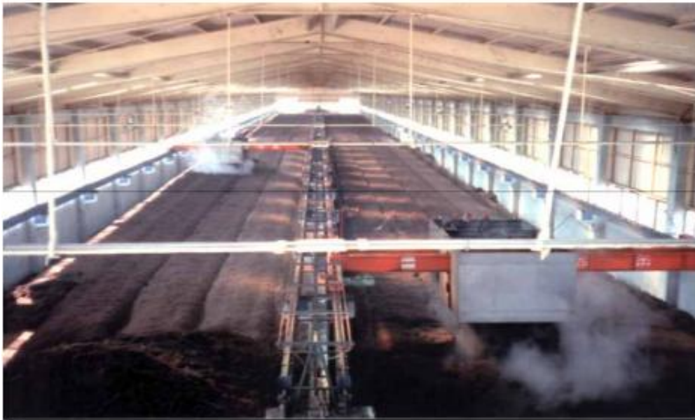
圖 2-4 利用翻堆機製作堆肥情形(經濟部工業局堆肥技術與手冊)
